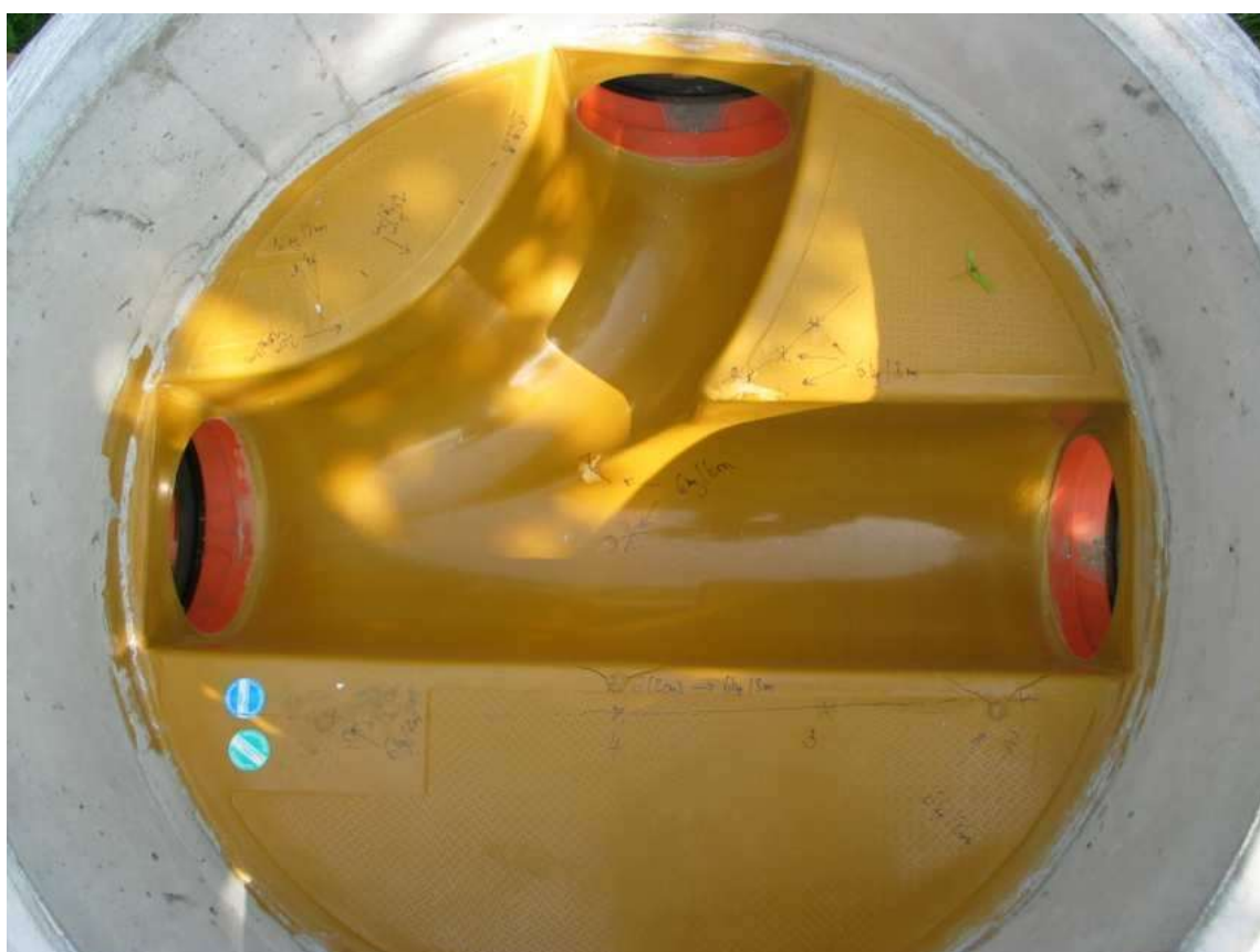
Immagine 7: campione di prova 7 / base pozzetto rivestito in PRFV (plastica rinforzata con fibre di vetro) con manicotti a tenuta
